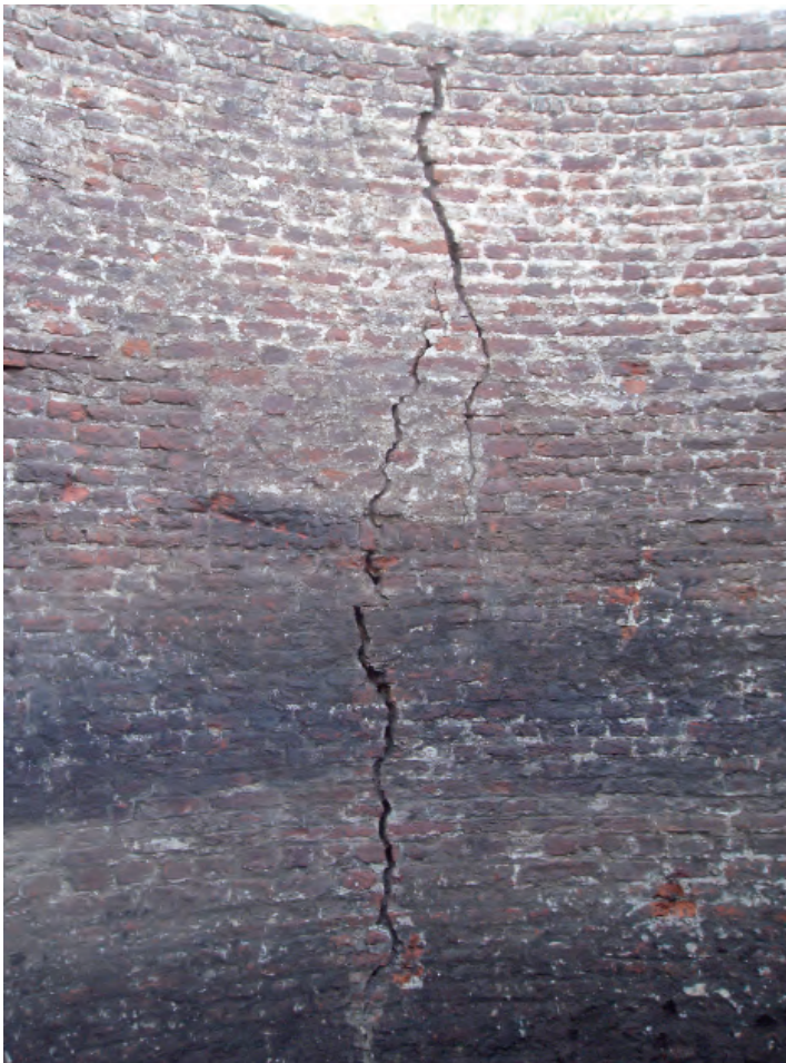
Afb. 6.9 Schietgat F15, aan de binnenzijde van de toren. Scheur F50 loopt zowel door het primaire muurwerk F13 als door het muurwerk van het jongere F12. Foto genomen richting het zuiden.
